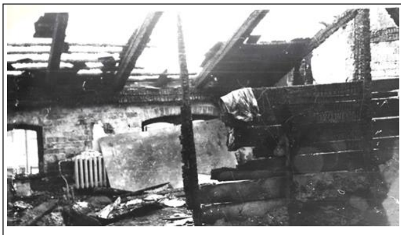
Ryc. nr 48. Zniszczenia budynku w wyniku pożaru.
