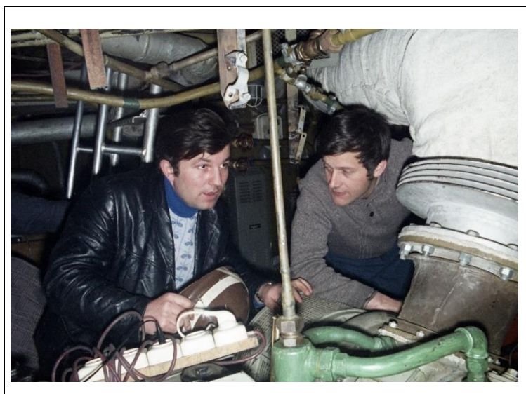
Ryc. nr 125. Malwin Przybylski w pomieszczeniu siłowni B410 (z lewej).
